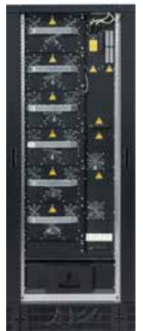
PU internal view
